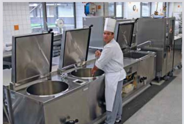
Die neue Küche wurde mit moderner Küchentechnik ausgestattet.
